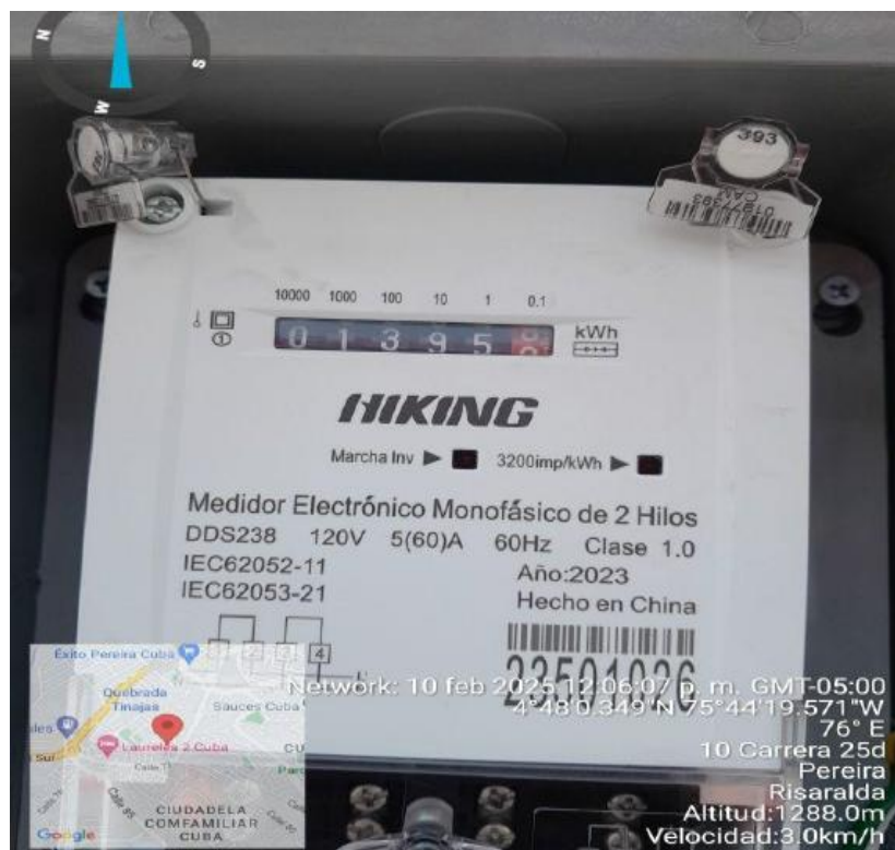
Foto No 2. Medidor No. 23501026 encontrado en terreno instalado y energizado sin encontrarse registrado en el sistema comercial de la compañía con una lectura acumulada de 1395 kWh.
