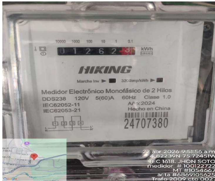
Foto No 1. Medidor No. 24707380 encontrado en terreno instalado y energizado sin encontrarse registrado en el sistema comercial de la compañía con una lectura acumulada de 1262 kWh, de los cuales ya se han cobrado 668 kWh (actas No. 6224846414-6219906165 del 26 de agosto de 2025), 266 kWh (acta No. 5807889159 del 15 de diciembre de 2025) y se encuentran pendientes por cobrar 328 kWh.
