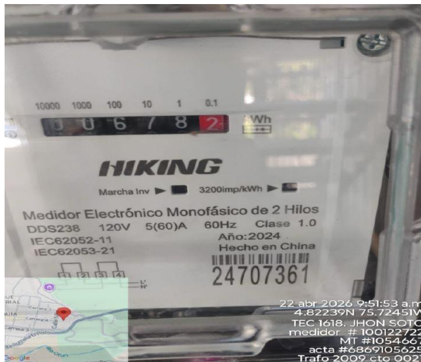
Foto No 2. Medidor No. 24707361 encontrado en terreno instalado y energizado sin encontrarse registrado en el sistema comercial de la compañía con una lectura acumulada de 678 kWh, de los cuales ya se han cobrado 510 kWh (acta No. 5807889159 del 15 de diciembre de 2025) y se encuentran pendientes por cobrar 168 kWh.
