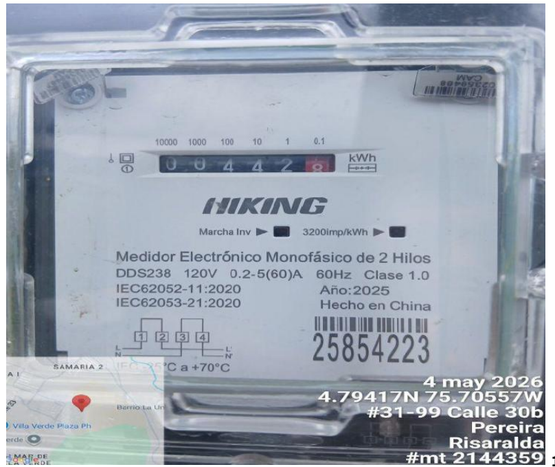
Foto No 1. Medidor No. 25854223 encontrado en terreno instalado y energizado sin encontrarse registrado en el sistema comercial de la compañía con una lectura acumulada de 442 kWh.
