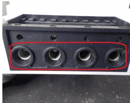
BLOQUE DE TERMINALES DETERIORADO (Terminales y tornillos sulfatados)
