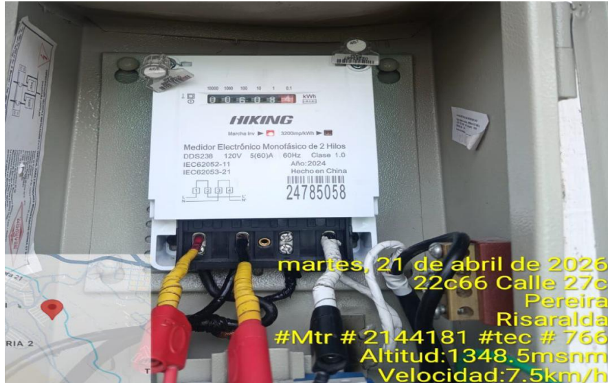
Foto No 1. Medidor No. 24785058 encontrado en terreno instalado y energizado sin encontrarse registrado en el sistema comercial de la compañía con una lectura acumulada de 608 kWh.
